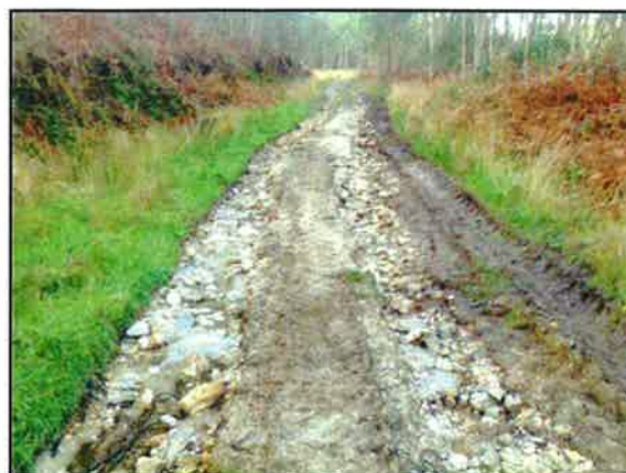
Fotografía 2 - Vista xeral do camiño de terra deteriorado
