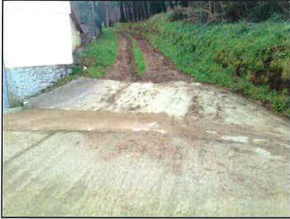
Fotografía 6 – Detalle de arrastres procedentes do camiño de servizo
