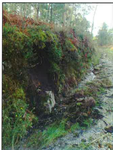
Fotografía 3 - Detalle de erosión dos noiros colindantes as vías
