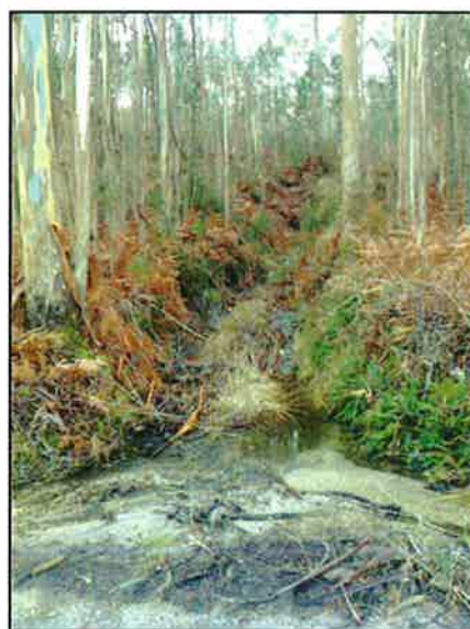
Fotografía 4 - Detalle do mal drenaxe das gabias existentes
