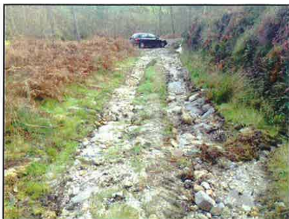
Fotografía 1 - Inicio do camiño de terra deteriorado
