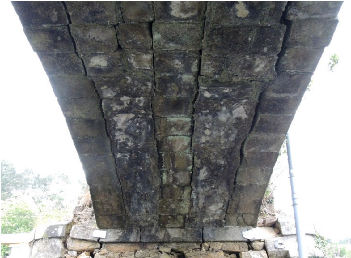
Fotografía 11.- Intradós de la bóveda derecha, siendo visible la abertura de las juntas no trabadas de los anillos que la forman
