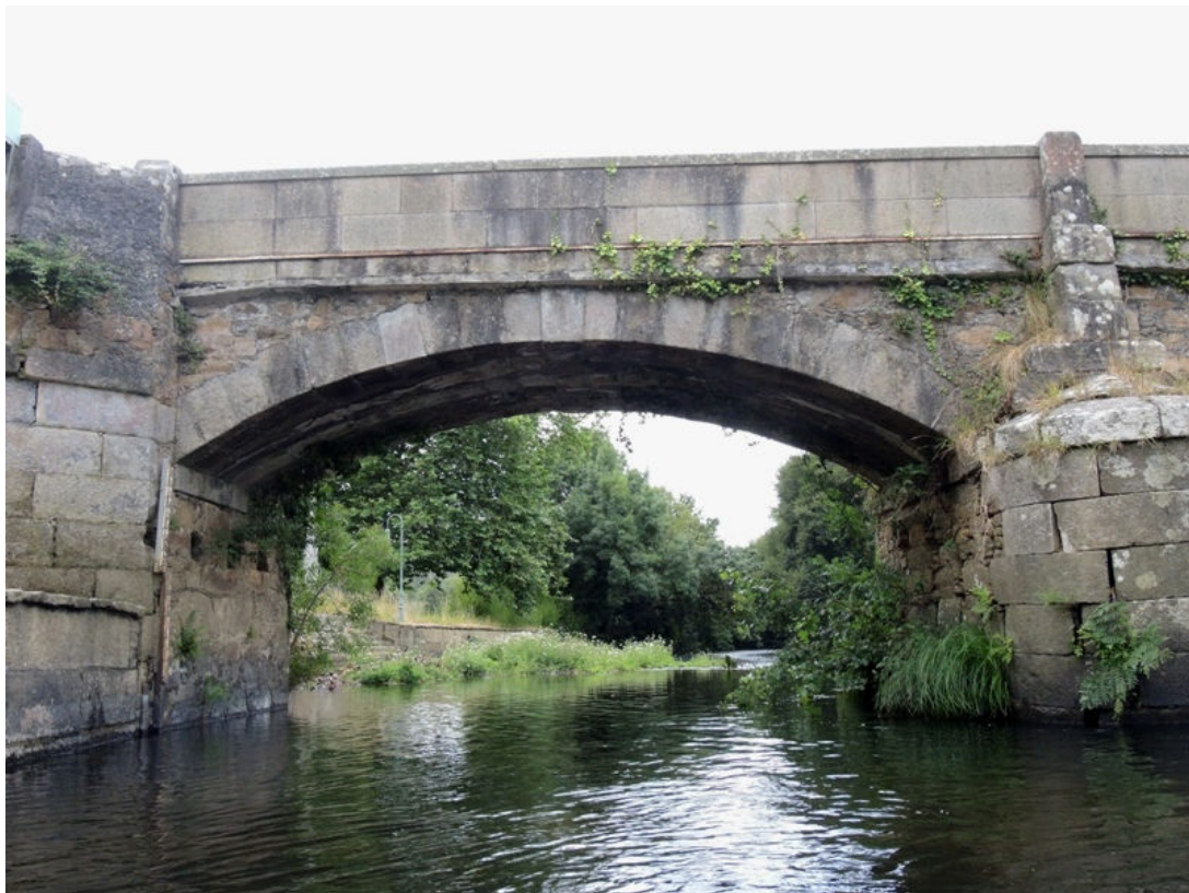
Fotografía 14.- Alzado aguas arriba de la bóveda izquierda sin apenas deformación
