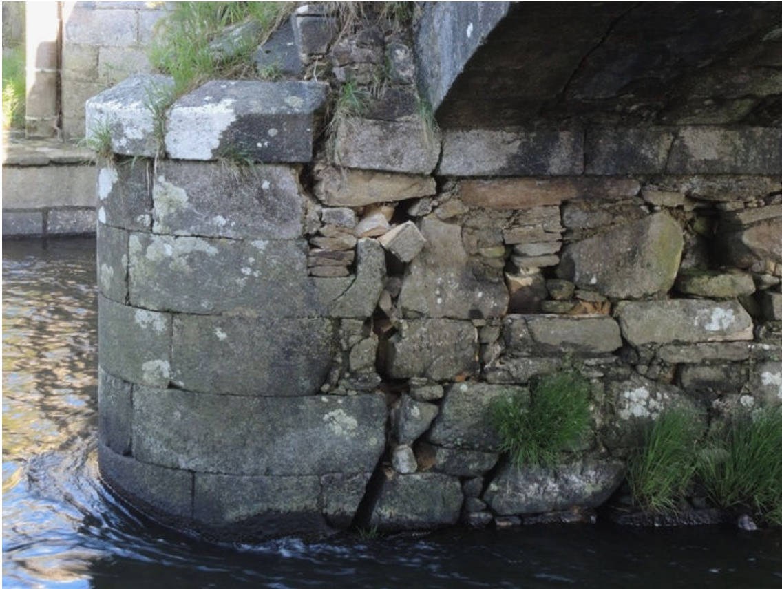
Fotografía 22.- Grieta de separación de la sillería del tajamar del cuerpo de la pila por la pérdida de piezas en su cimentación
