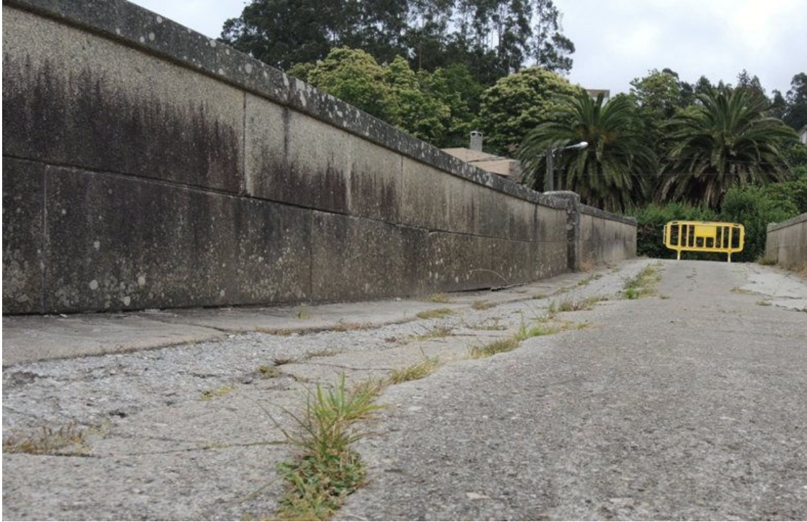
Figura 16.- Hundimiento de la calzada sobre el arco derecho
