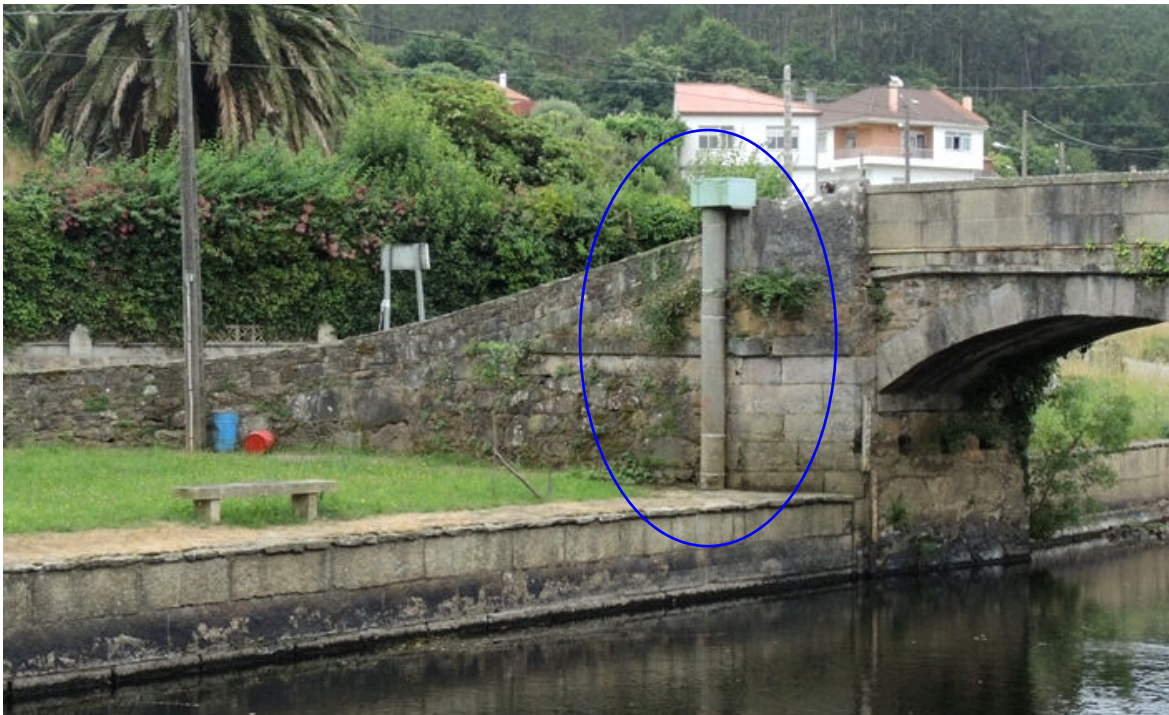
Figura 25.- Instalación de aforos fuera de uso
