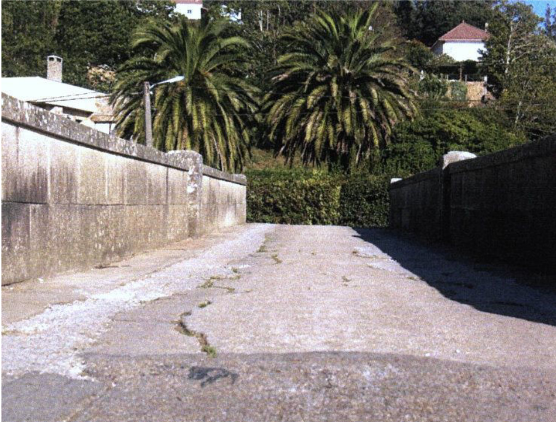
Fotografía 5.- Calzada con el pavimento agrietado y reposición de la tubería de abastecimiento que cruza el puente (Foto M. Doce)
