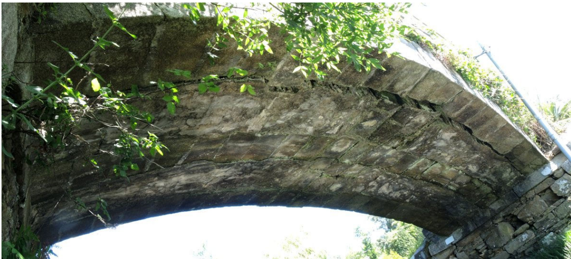
Fotografía 12.- Intradós de la bóveda derecha, siendo visible la abertura y descenso de las juntas de los anillos
