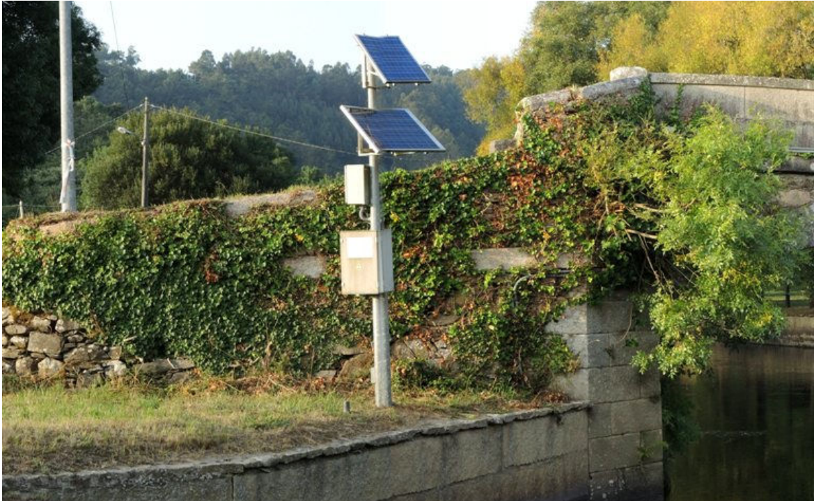
Figura 24.- Paneles solares de la estación de aforos y control de contaminación
