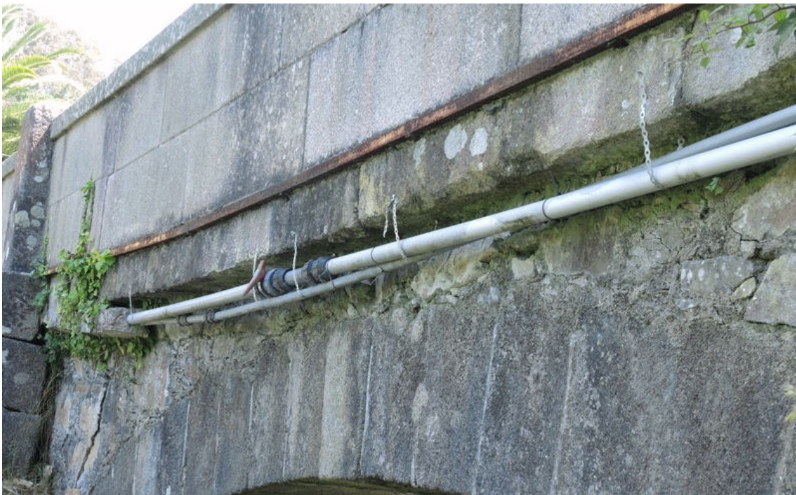
Figura 26.- Tuberías de abastecimiento ancladas a la cornisa aguas arriba
