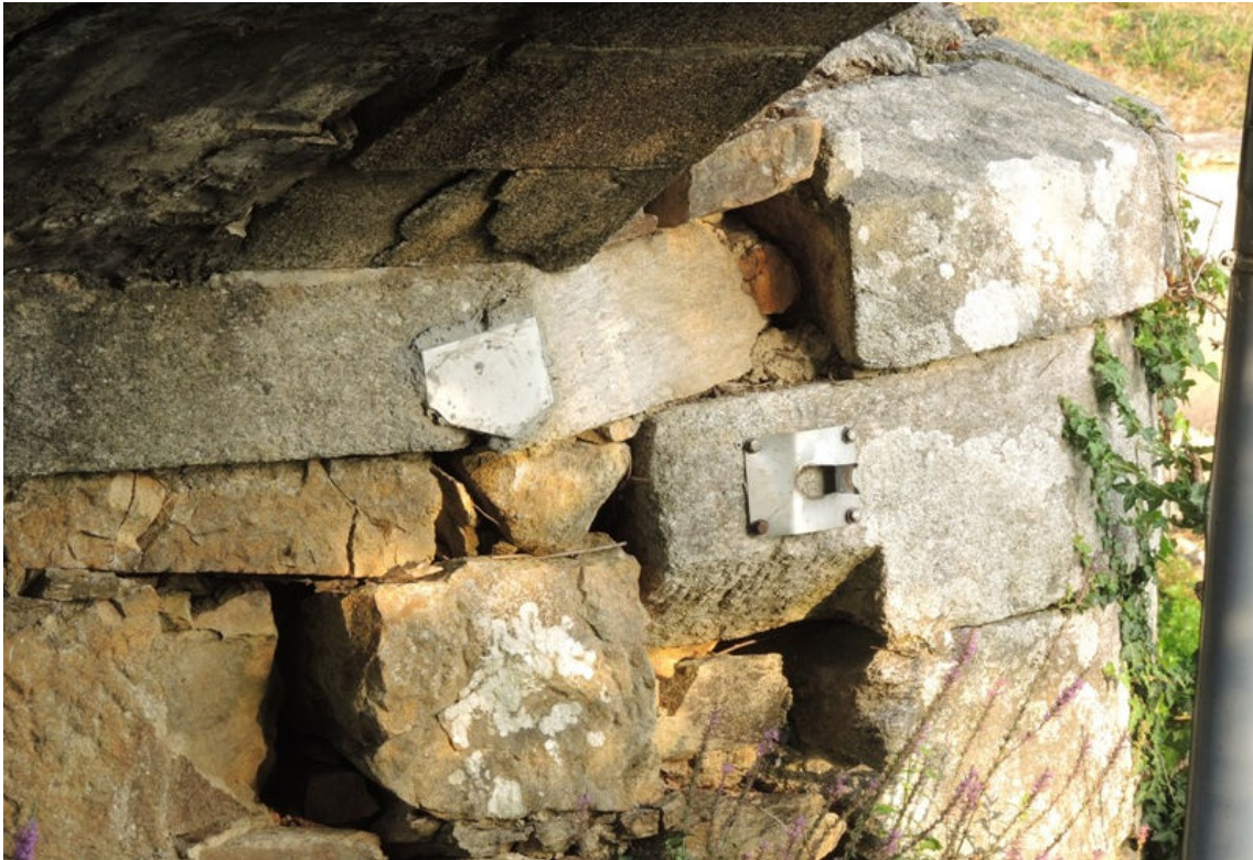
Fotografía 24.- Detalle de los daños de la pila bajo el arco derecho
