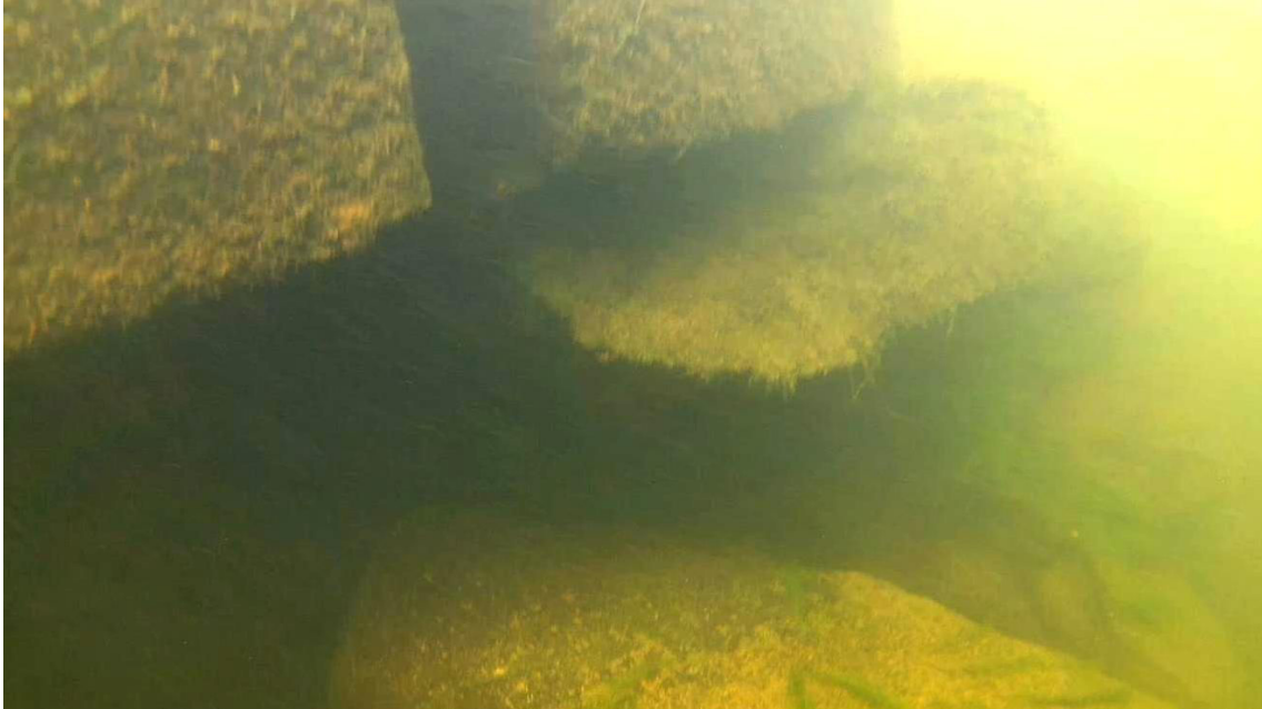
Figura 31.- Descalce de la base del tajamar
