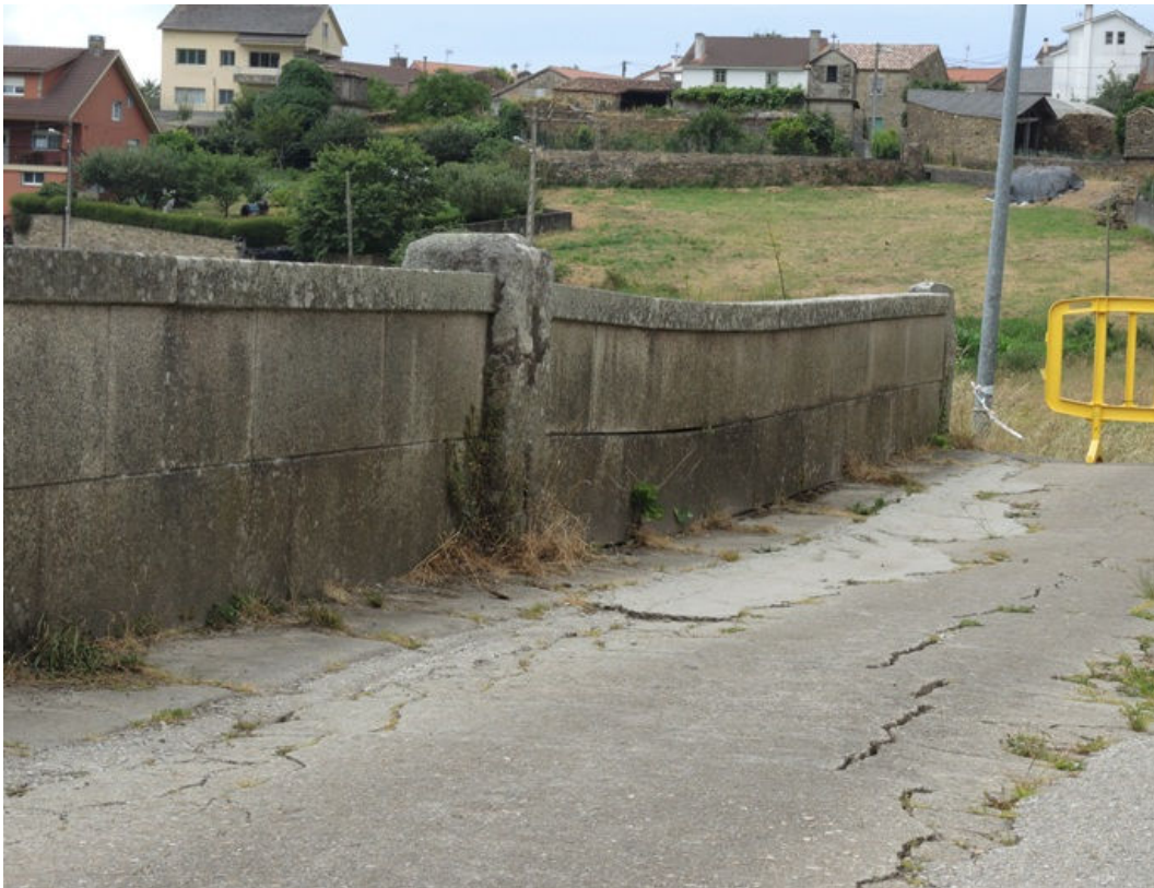
Fotografía 37.- Pretil aguas abajo sobre el arco derecho deformado por el asentamiento del arco
