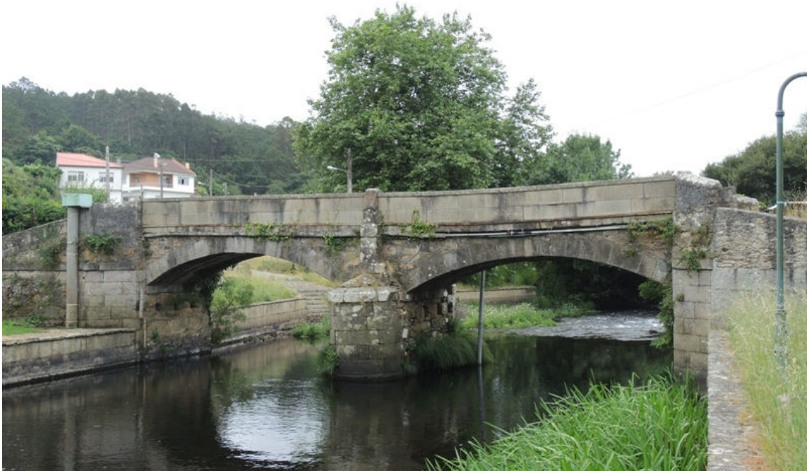
Fotografía 7.- Alzado aguas arriba, siendo visibles las deformaciones experimentadas por el puente
