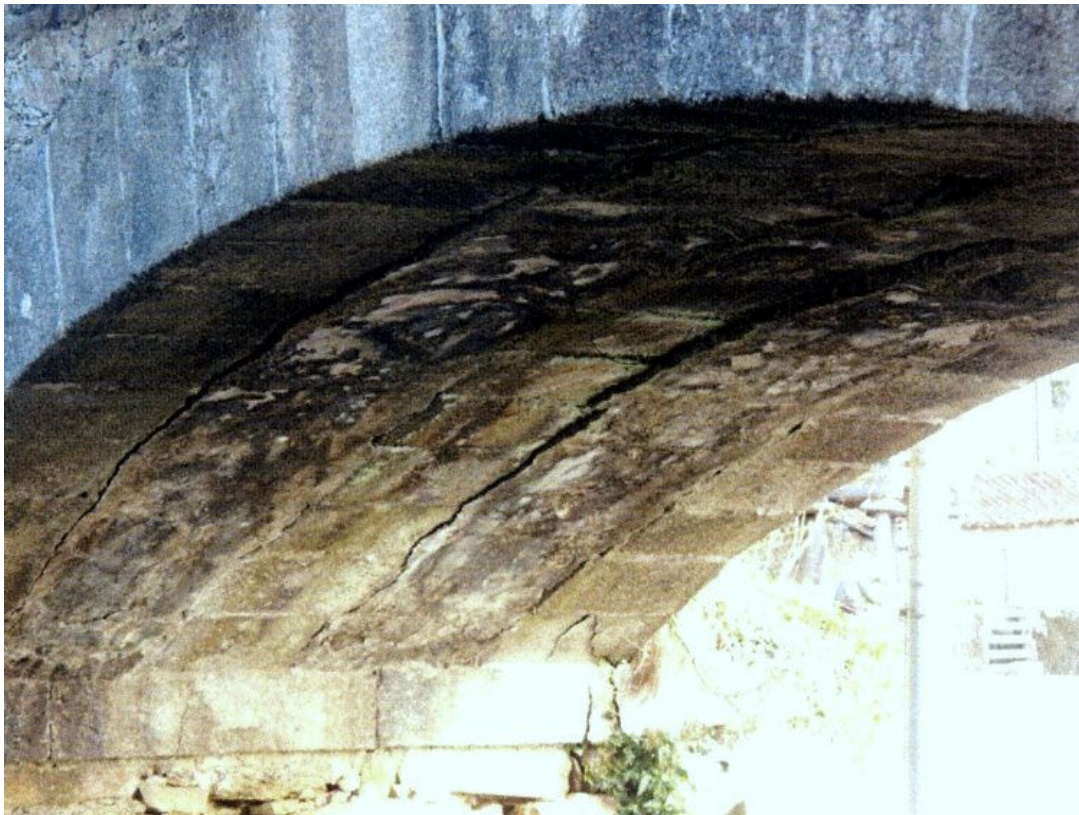
Fotografía 4.- Intradós del arco derecho con los anillos separados y deformados (Foto M. Doce)
