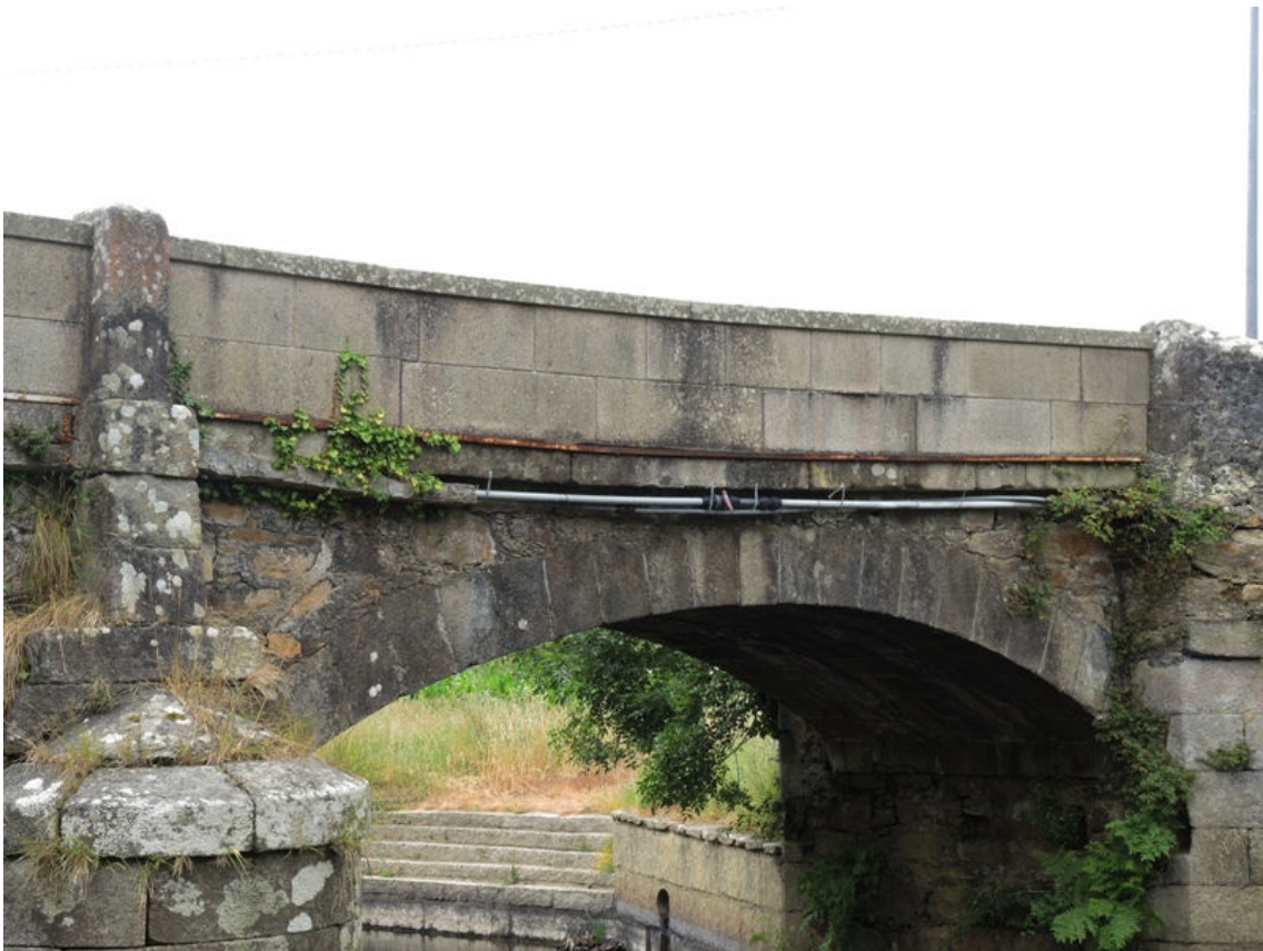
Fotografía 10.- Alzado aguas arriba de la bóveda derecha, siendo visible su descendimiento por el desplazamiento y giro experimentado por el descalce de la pila
