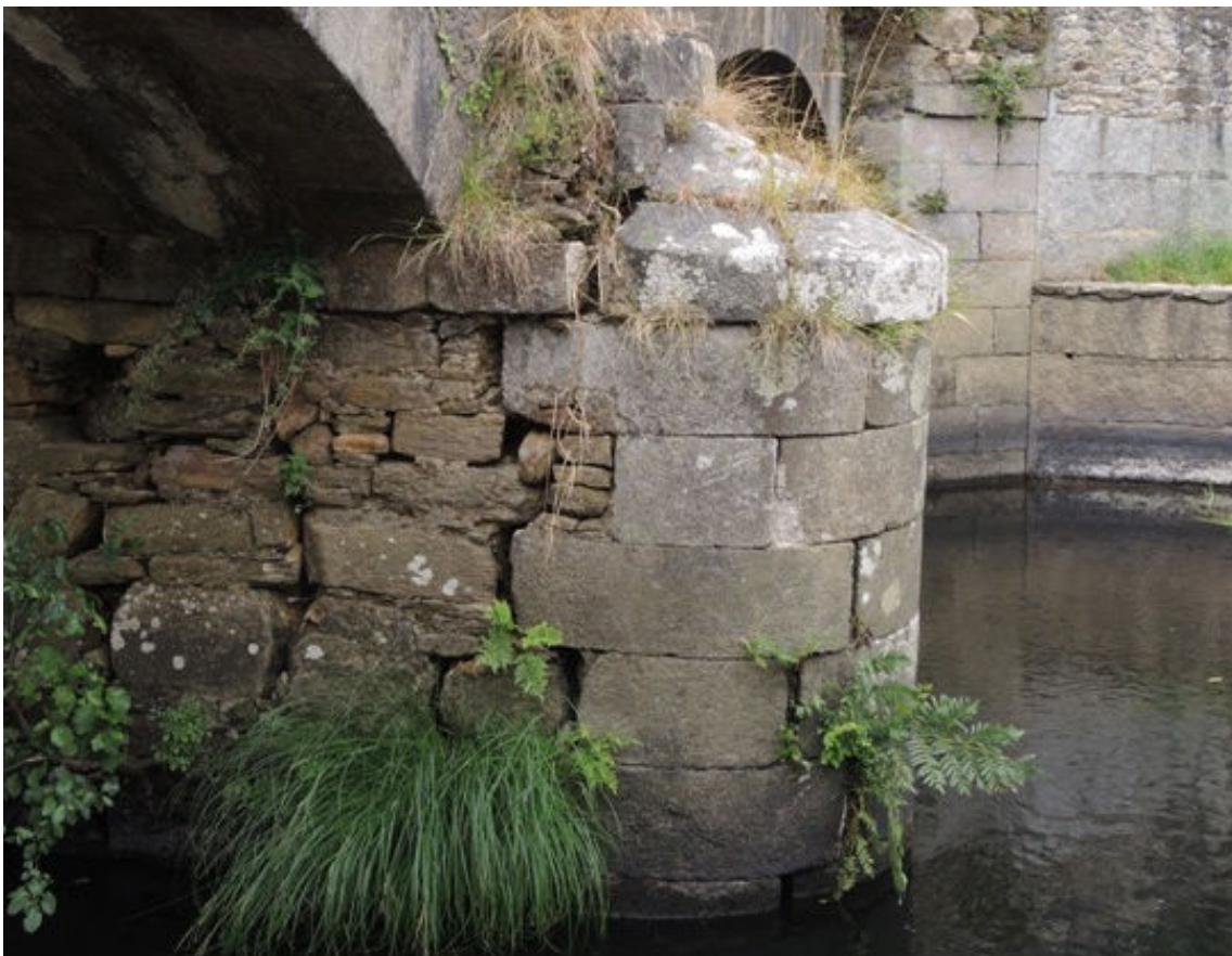
Fotografía 25.- Detalle de los daños de la pila bajo el arco izquierdo
