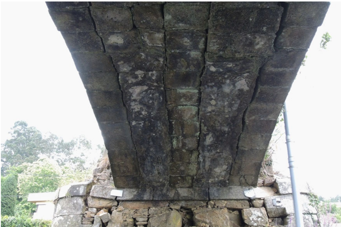
Figura 6.- Intradós de la bóveda derecha con las juntas abiertas de los cinco anillos
