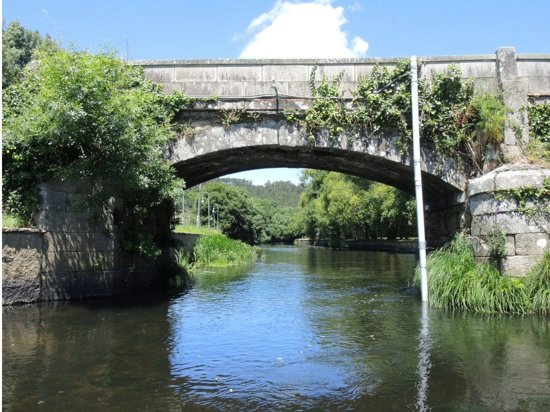
Fotografía 13.- Alzado aguas abajo de la bóveda derecha, siendo visibles deformaciones menores
