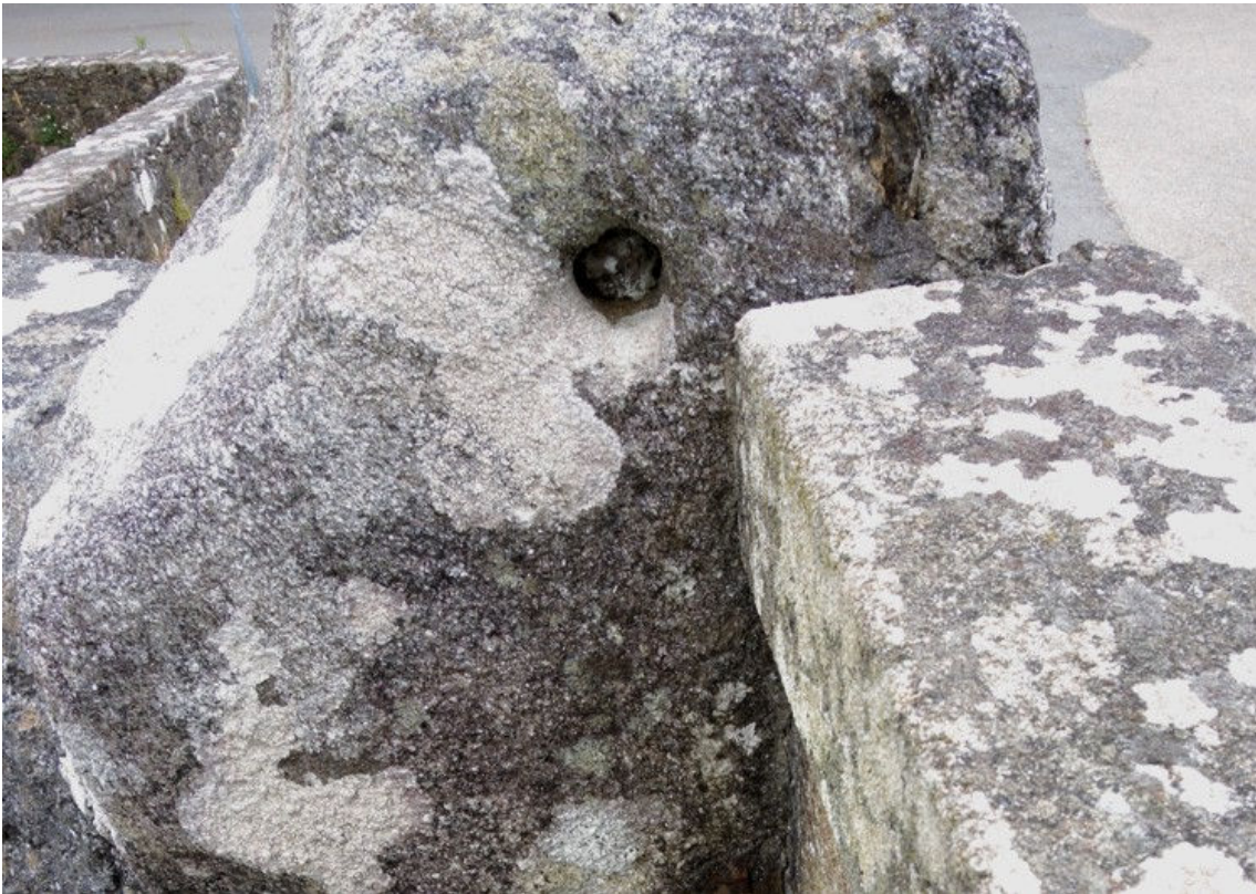
Figura 17.- Huevo de empotramiento de la antigua barandilla con barras de hierro
