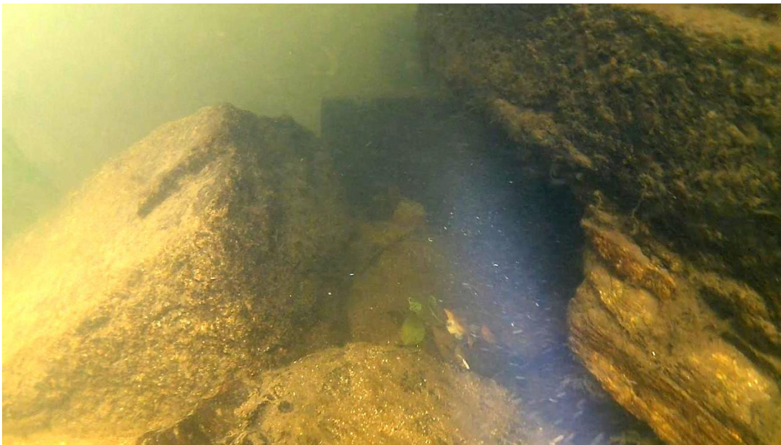
Figura 32.- Descalce de la cimentación de la pila
