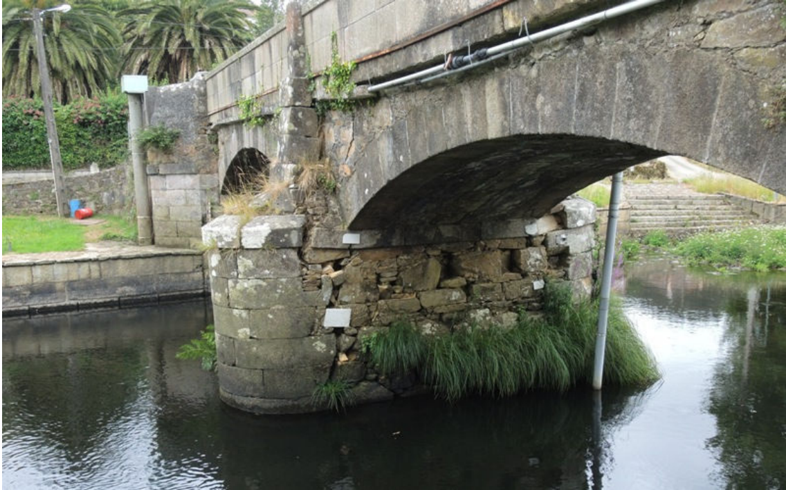
Fotografía 20.- Vista de la pila dañada desde la margen derecha
