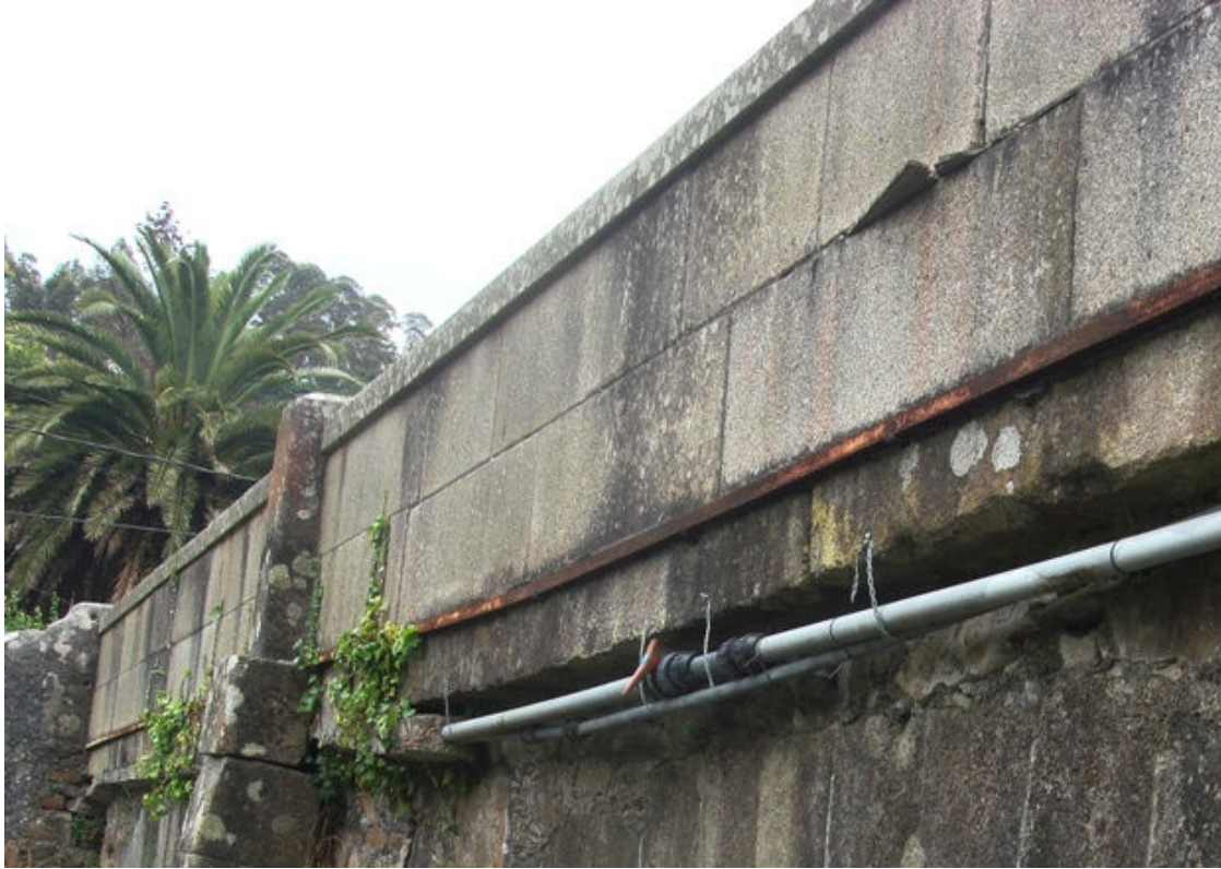
Fotografía 36.- Perfil metálico sobre el que apoya un pequeño vuelo de la sillería del pretil
