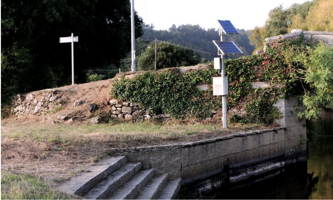
Fotografía 18.- Estribo derecho aguas abajo con parte del muro de contención del acceso derruido
