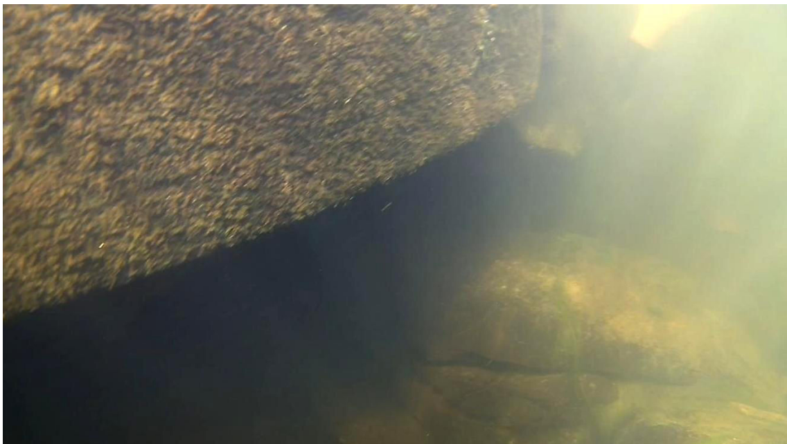
Fotografía 23.- Descalce por pérdida de piezas en la cimentación del tajamar
