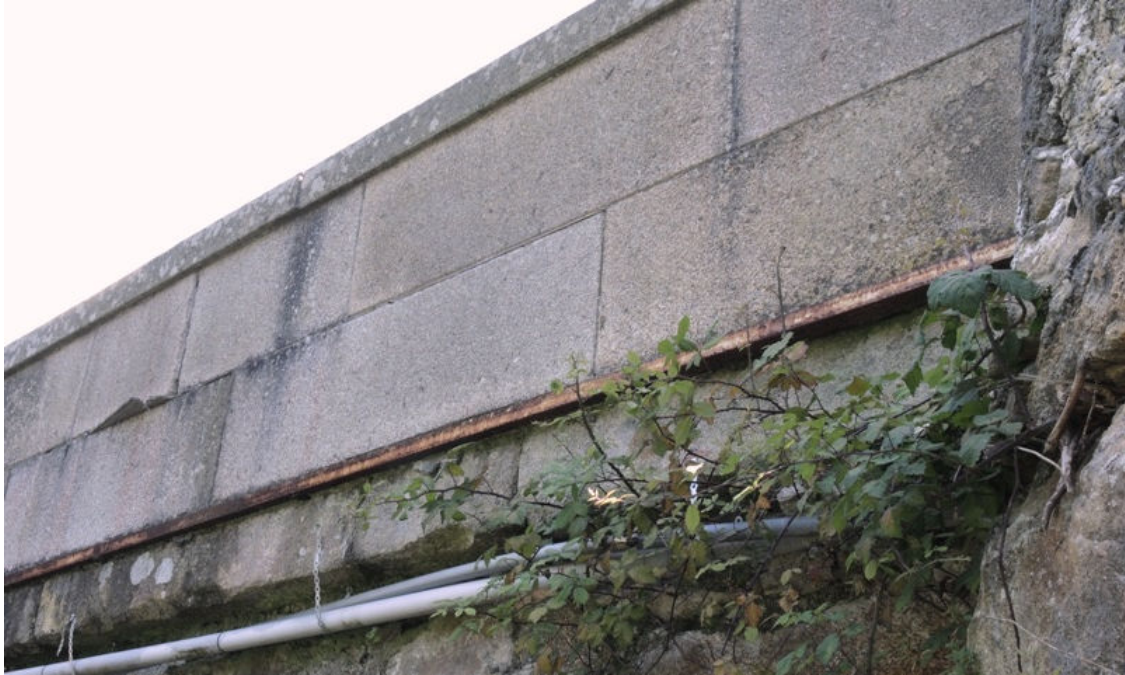
Figura 18.- Perfil metálico de refuerzo de apoyo de la sillería de los pretilos
