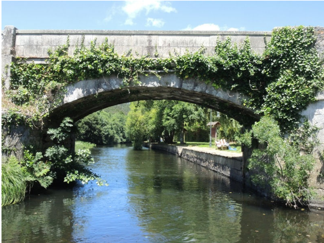
Fotografía 15.- Alzado aguas abajo de la bóveda izquierda sin apenas deformación
