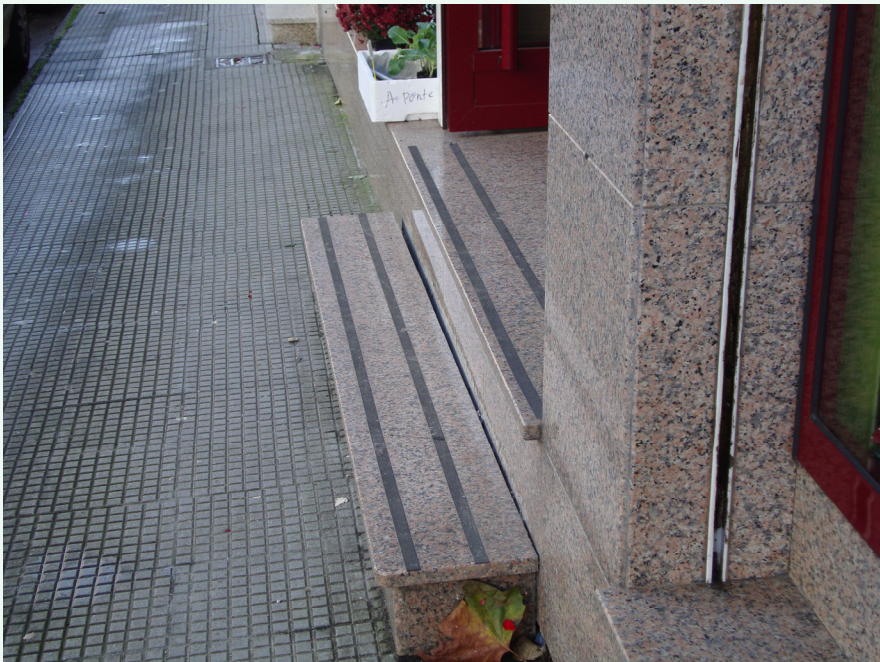
Detalle de aceras y la separación de los escalones de acceso al local en Eduardo Pondal respecto al edificio.
