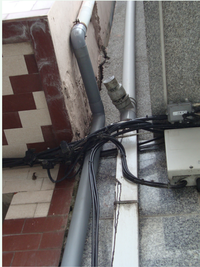
Grietas y posible desplome entre los edificios de Eduardo Pondal 13 y 15
