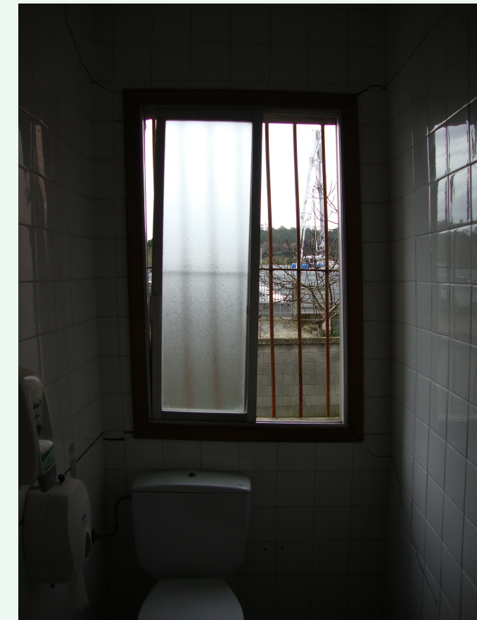
Oficina Banco Gallego: descuadre de la ventana del aseo a causa de la excesiva deformación
