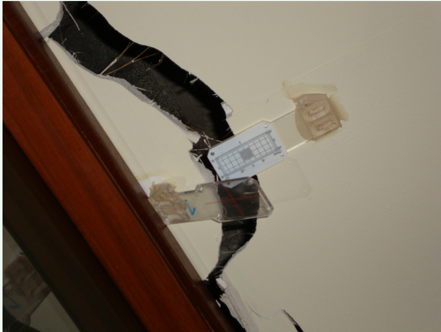
Oficina Banco Gallego: fisurómetro nº 1. Fue tanta la deformación que excedió su capacidad de medición.
