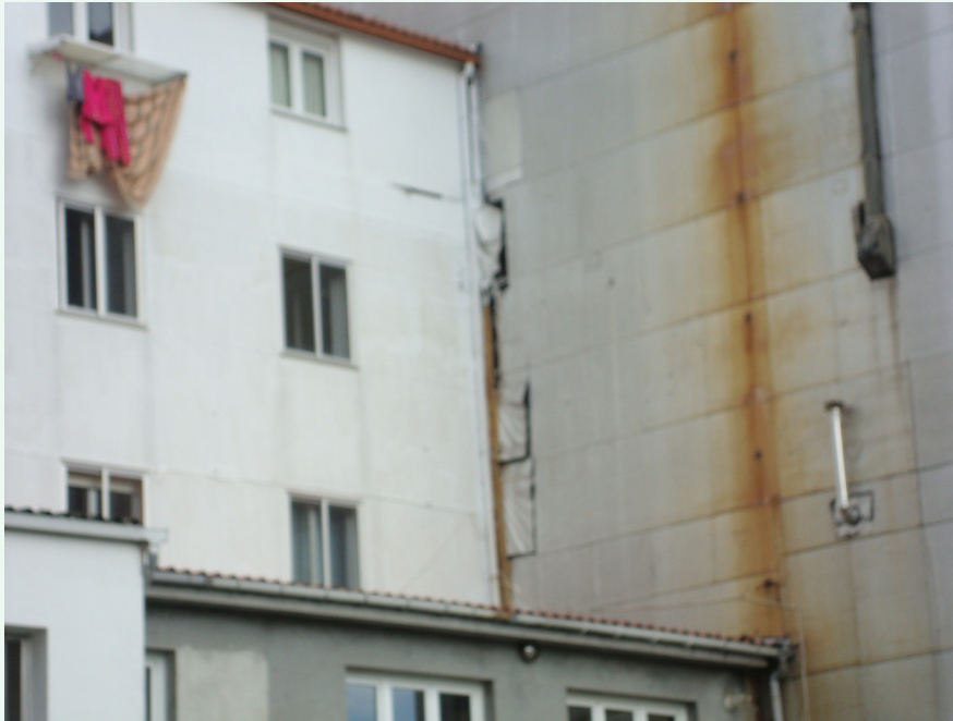
Traseras de Eduardo Pondal 16 y 18. Desprendimientos de la tela asfáltica debido al movimiento de los edificios.
