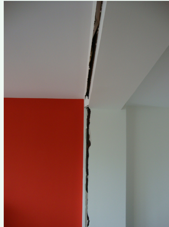
Oficina de Reale Seguros: desprendimiento del añadido respecto al edificio principal en muro de despacho
