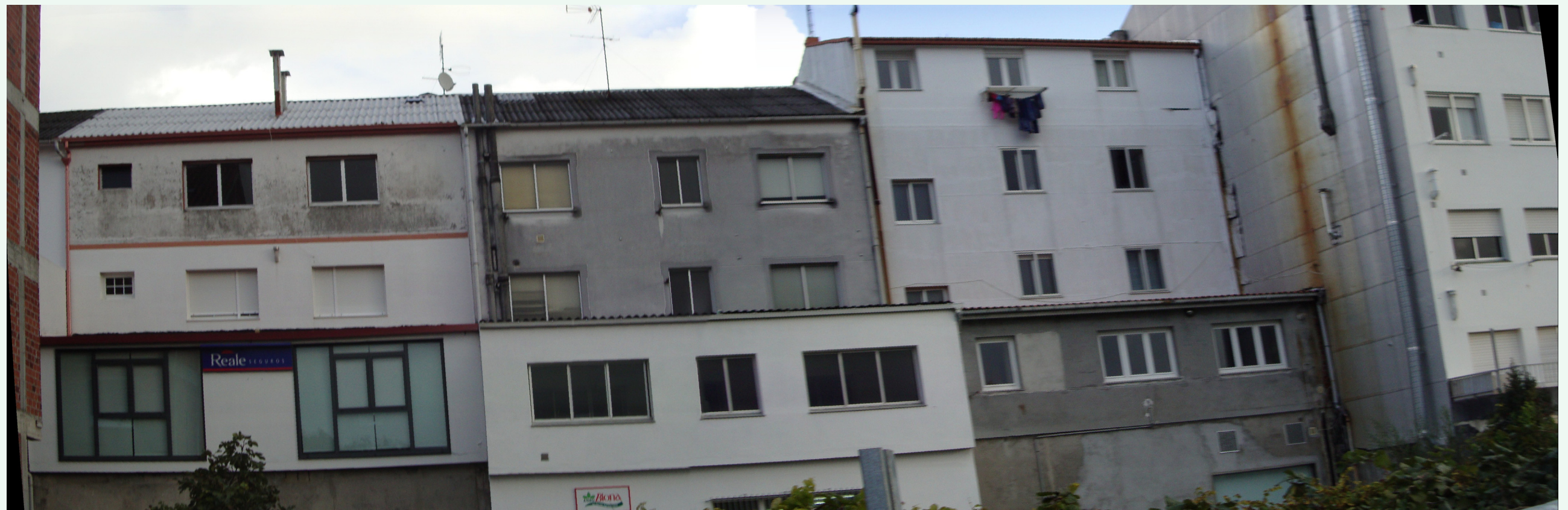
Vista general de algunas de los añadidos en la Avda. Eduardo Pondal
