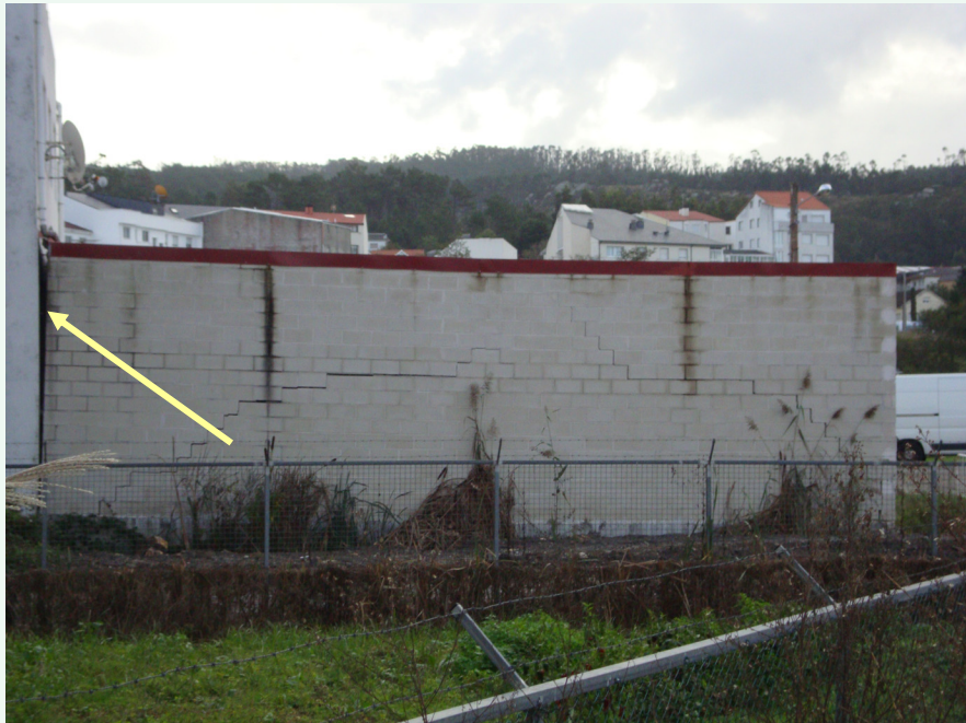
Grietas a 45° y horizontales en el añadido de Eduardo Pondal 22. Se indica la separación del edificio principal.
