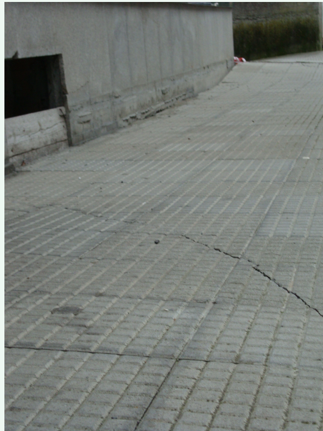
Misma acera anterior, desde otro ángulo para apreciar en detalle la grieta en la baldosa
