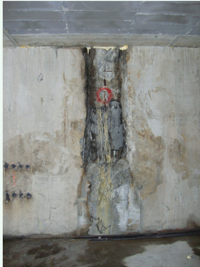
Sótano del edificio de Travesía Relleno. Filtraciones en la zona del pilote y el muro pantalla.
