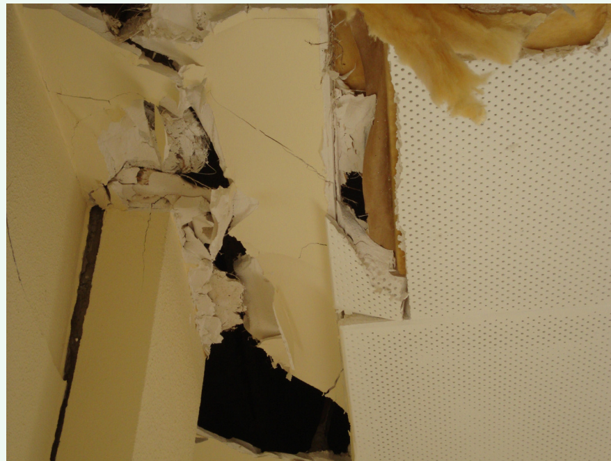
Bajo comercial del Banco Gallego: detalle unión de cielorraso con muro
