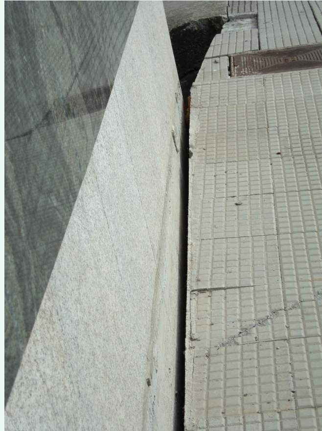
Separación de la acera respecto a al fachada del local comercial del edificio de Travesía Relleno 1
