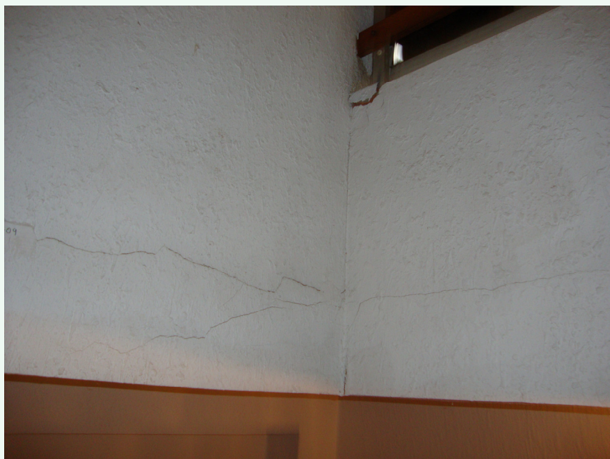
Eduardo Pondal 14: fisura en zona de escaleras, controladas posteriormente con fisurómetro.
