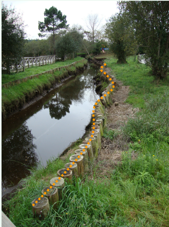
Ribera del río Rego de los Prados antes de su desembocadura. Se puede apreciar los movimientos sufridos por pilotes de madera del margen izquierdo.
