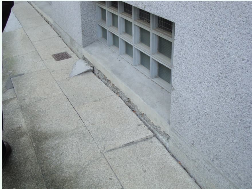
Similar a la foto anterior. Acera lindera al Pelamio en el edificio de Eduardo Pondal 20
