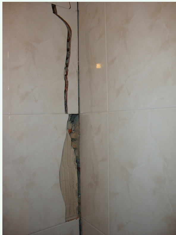
“Santy Fotógrafo”: separación de los muros en aseo.
