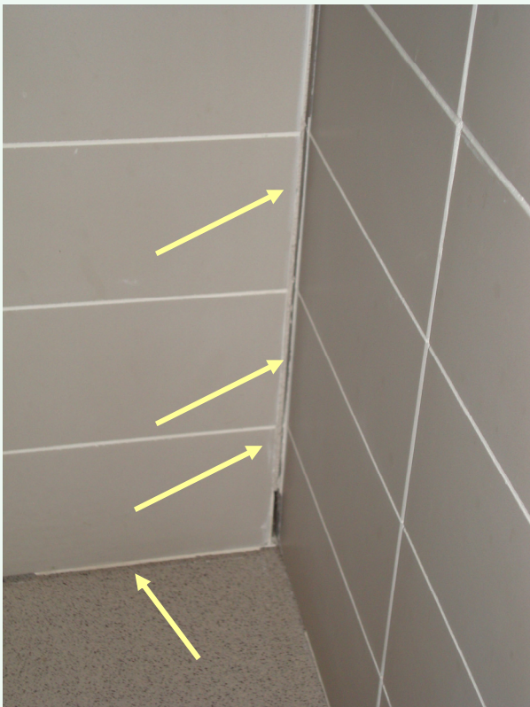
Oficinas de La Caixa: aseos. Separación de los paramentos entre sí y respecto al pavimento.
