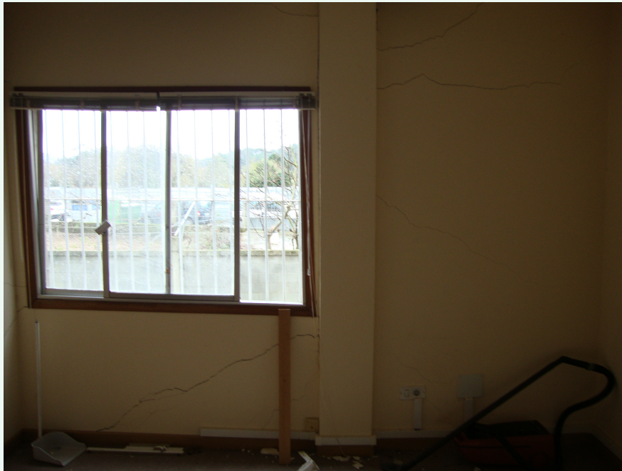
Oficina Banco Gallego: fachada trasera de despacho sin uso.
