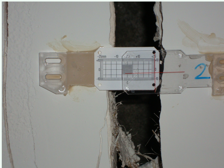
Banco Gallego: detalle del fisurómetro nº 2 que quedó inutilizado
