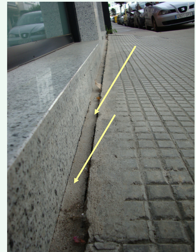
Bajo de Eduardo Pondal 18, fachada norte. Acera de la entrada principal. Hundimiento de arqueta y separación de la acera respecto a la fachada. Se observa el relleno de la grieta mediante lechada de cemento.
