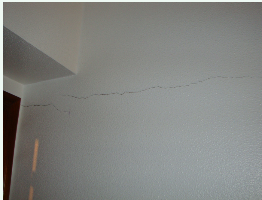
Vivienda de Travesía Relleno. Grietas horizontales por esfuerzo de corte.
