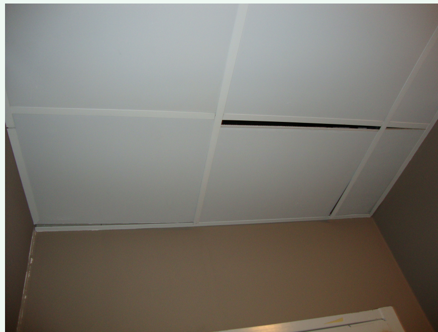
Oficina de La Caixa: desprendimientos de placa del cielorraso zona de aseos y almacén.
