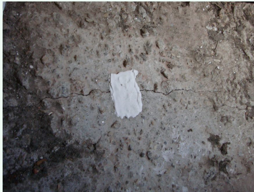
Eduardo Pondal 14: fisura en zona de trasteros, en la última planta. Testigo de yeso colocado por los ocupantes del inmueble.
