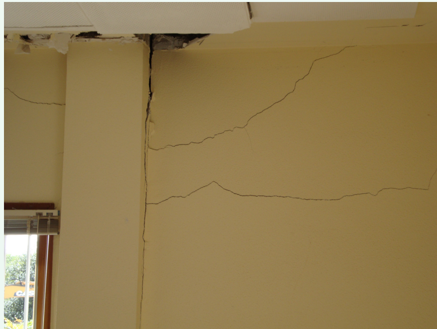
Banco Gallego: grietas en fachada trasera
