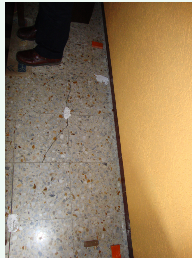
Eduardo Pondal 14, 5º Derecha: detalle de fisuras en el pavimento del dormitorio, donde posteriormente se efectuó un control con fisurómetro. Los testigos de yeso fueron colocados por los ocupantes del inmueble
