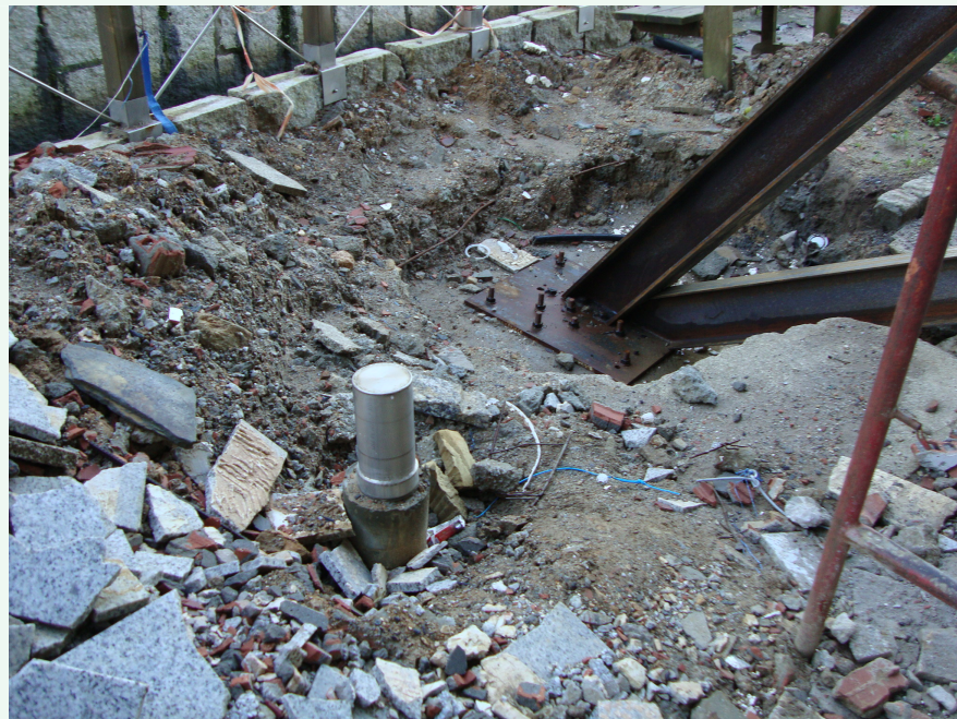
Apuntalamiento del edificio de Eduardo Pondal 18. Extensómetro nº 3
