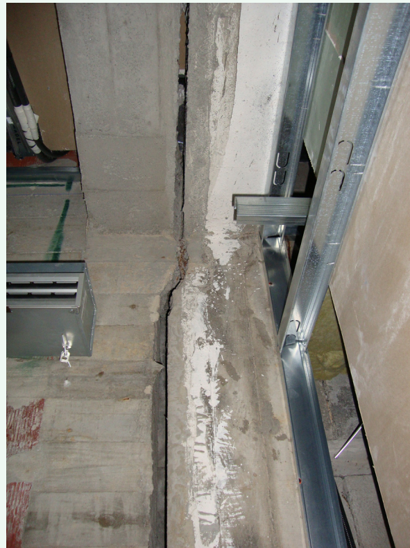
Oficina de La Caixa: parte trasera sin acondicionar. Separación de la construcción añadida del edificio principal.
