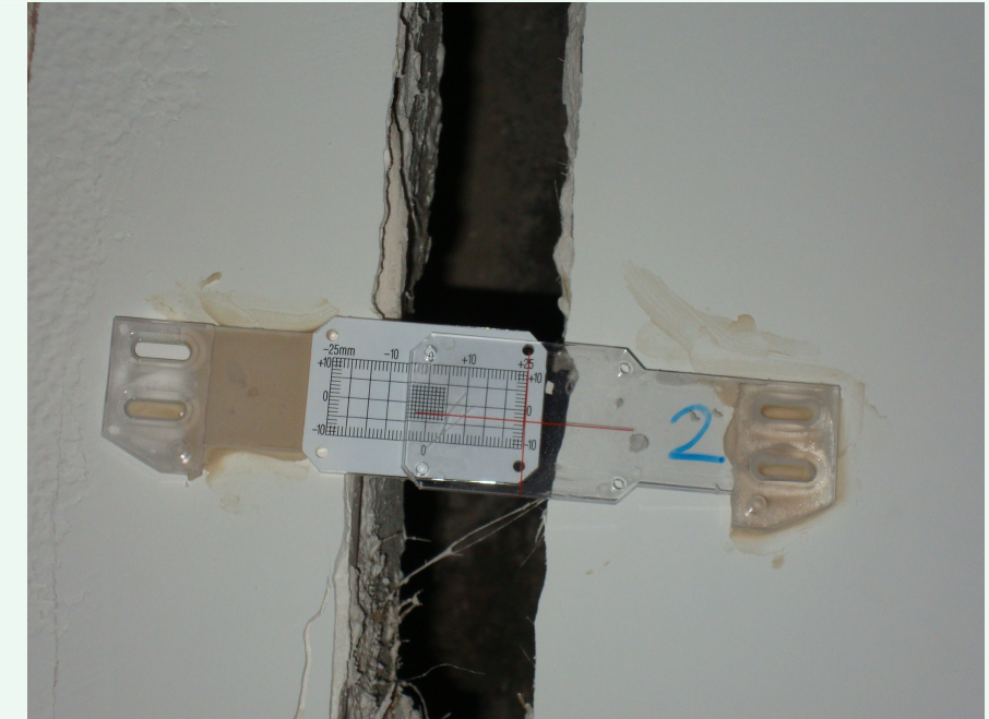
Oficina Banco Gallego: fisurómetro nº 2 al límite de su capacidad de medición.
