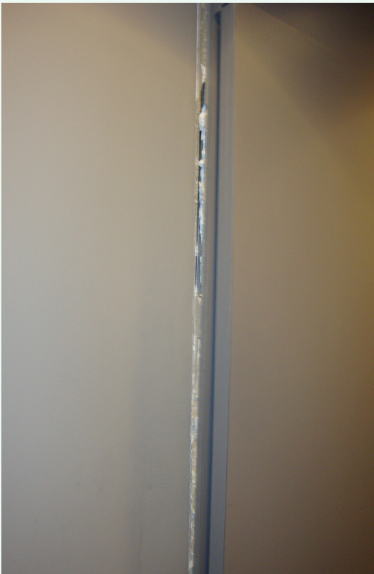
Separación de la puerta del despacho respecto al muro en la oficina de La Caixa
