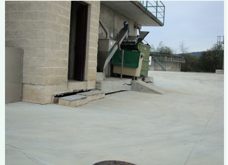
Hundimientos en el pavimento de la EDAR
