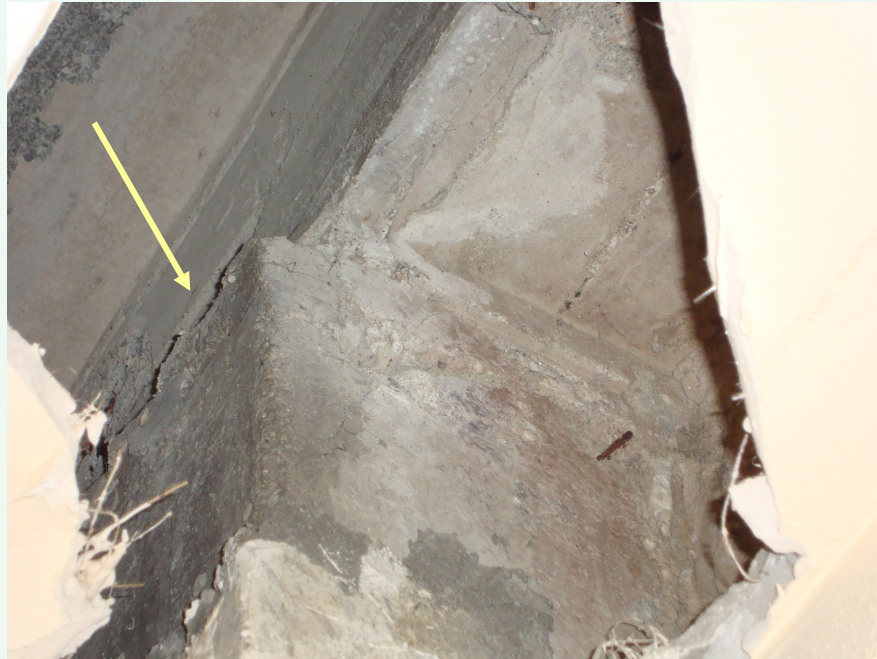
Banco Gallego: fisura en el encuentro viga-pilar del despacho trasero, sin utilizar
