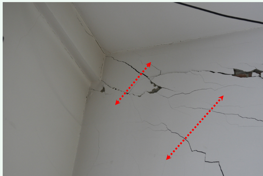
6/10/09: grietas a 45° en muro Este del almacén del local comercial.
