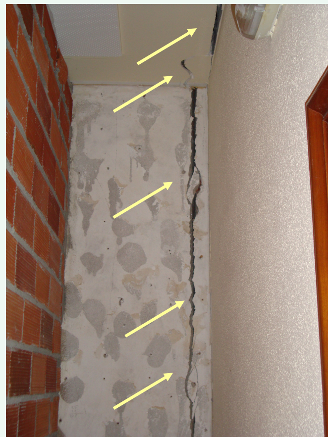
Banco Gallego: grieta de separación entre la edificación añadida y el edificio principal.
