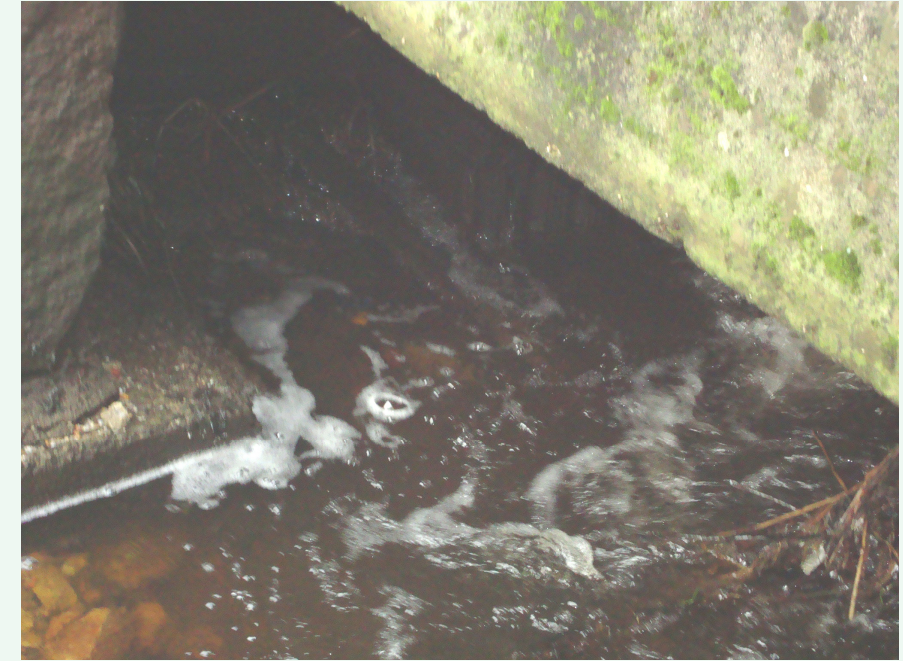
Cauce del Pelamio debajo del puente de Eduardo Pondal, y después de sufrir un desvío de 90 ° frente al edificio del número 18. Esta es una de las causas que en el informe se apuntan como posibles del deterioro que sufrieron las cimentaciones del edificio.
