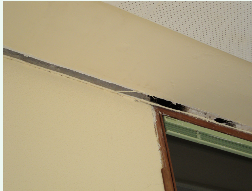
Banco Gallego: detalle separación cielorraso y muro
