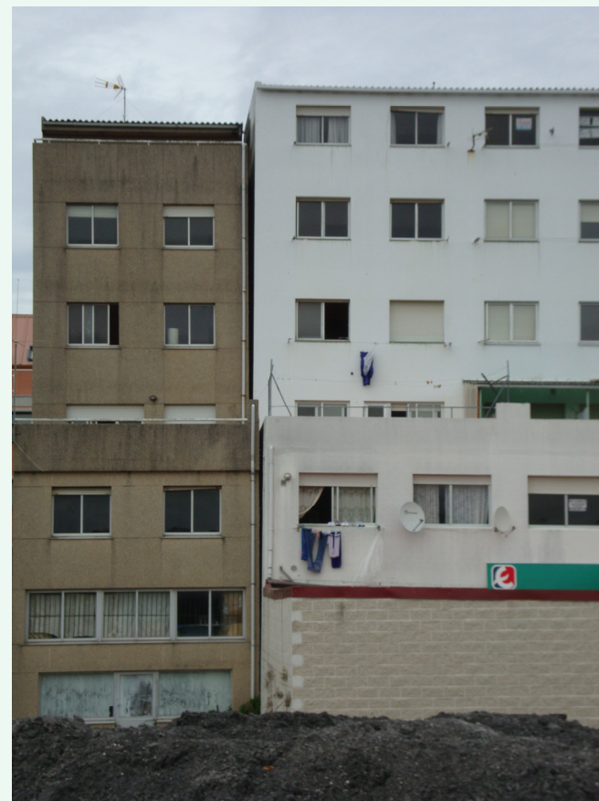
Vista posterior de los edificios de Eduardo Pondal 20 y 22 con desplome.
