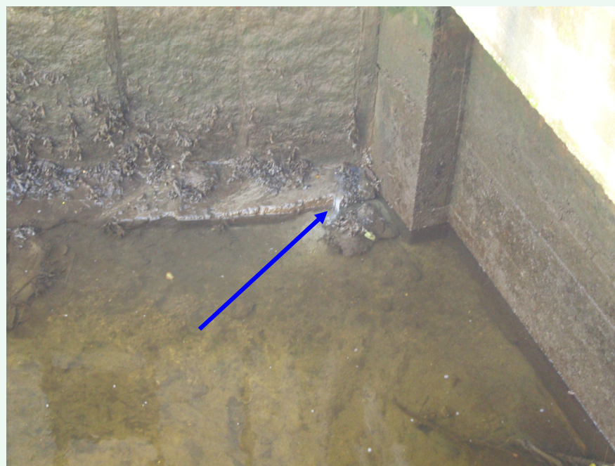
Filtraciones de agua localizadas en el encauzamiento del río Pelamio, entre el cierre de mampuestos de granito y la estructura de hormigón armado del puente de la Avda. Eduardo Pondal.
