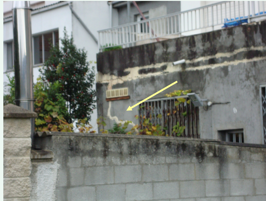
Grieta reparada en la parte trasera del bajo del edificio de Eduardo Pondal 18 (Restaurante Elías)
