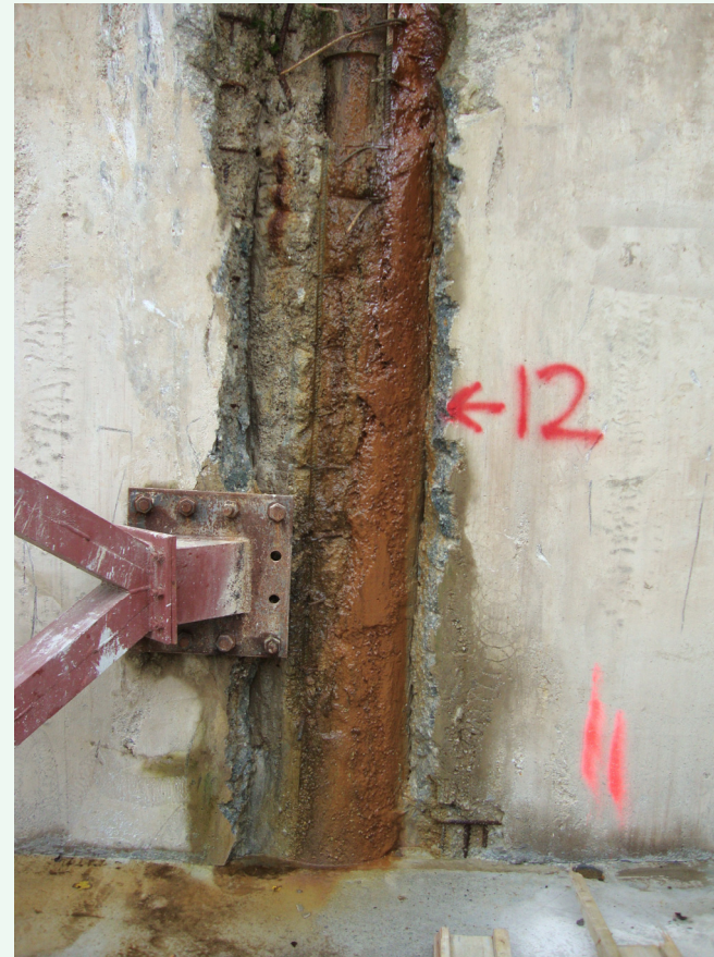
Sótano del edificio de Travesía Relleno. Detalle de filtraciones en un muro pantalla.
