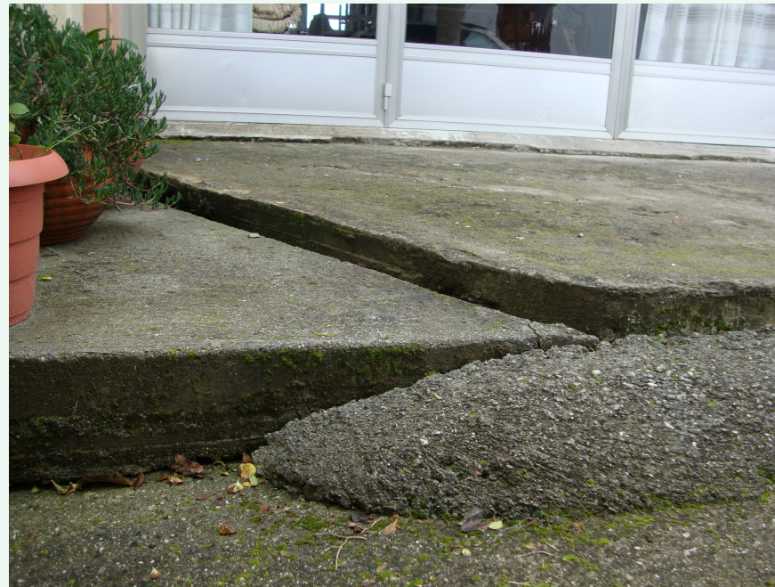
Eduardo Pondal 27, rotura de acera interior de la finca
