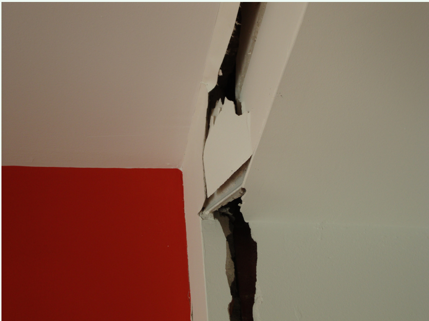
Oficinas de Reale Seguros: “descuelgue” del añadido respecto al edificio principal en la unión del muro con el cielorraso
