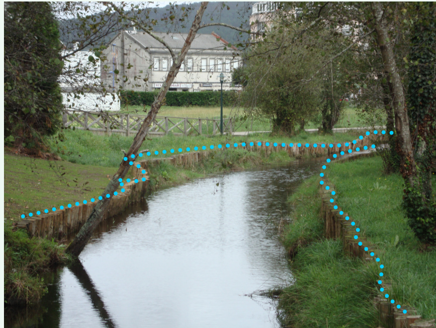
Ribera del Rego de los Prados, donde se pueden observar los desplazamientos de los pilotes de madera, destacados con líneas de puntos azules.
